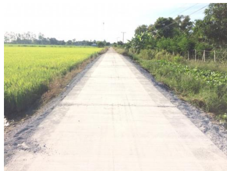
ซ่อมแซมถนนคอนกรีต หมู่ที่ ๑ และหมู่ที่ ๒
